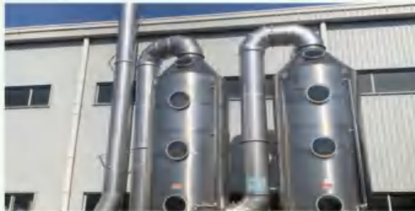
电泳废气安装二级水喷淋处理装置
